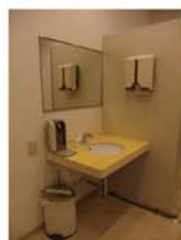
温水手洗い設備 ペーパータオル アルコール消毒
