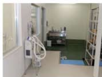
サニタリー室の衛生設備
